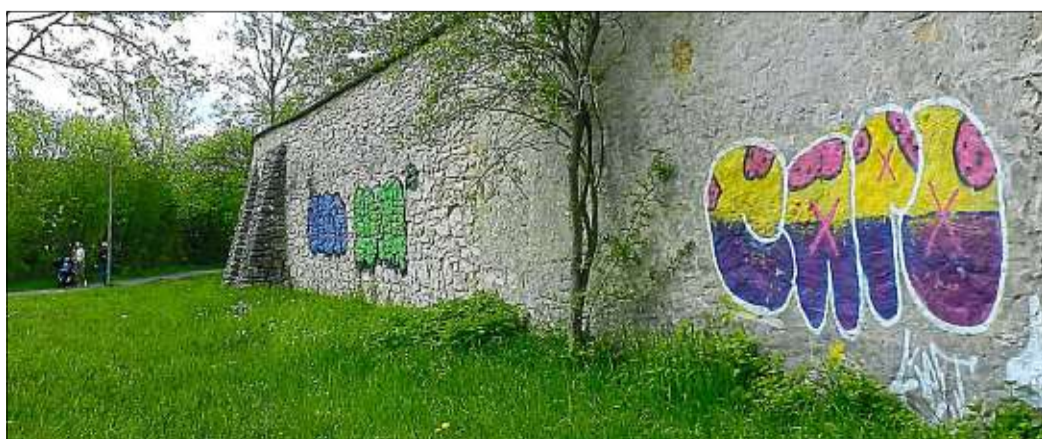
Schmierfinken am Werk: Die Mauer des ehemaligen Klosters der Augustinerinnen von Marienstein am Wander- und Radweg an der Altmühl ist beschmierig worden. Etwa ein Dutzend Schriftzüge wurden aufgesprüht. Das rund 550 Jahre alte Gemäuer aus Bruchsteinen ist nur mit viel Aufwand zu reinigen. Besitzer der Mauerteile sind die jeweiligen Grundstücksinhaber. Die Polizei ist informiert. Foto: Ettl
